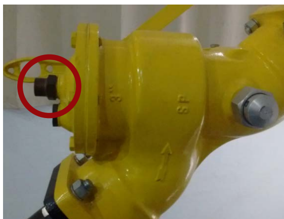
Foto 14. Válvula 417 de 3 pulgadas.
