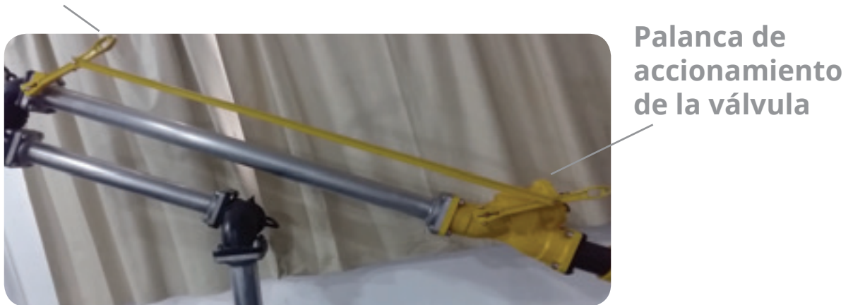
Foto 18. Barra fijada en la palanca de la válvula hasta la palanca de control remoto.
